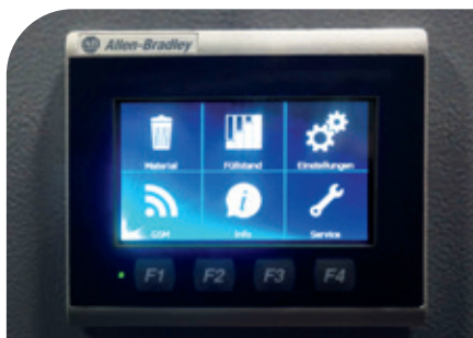
Moderne Steuerung mit Display
